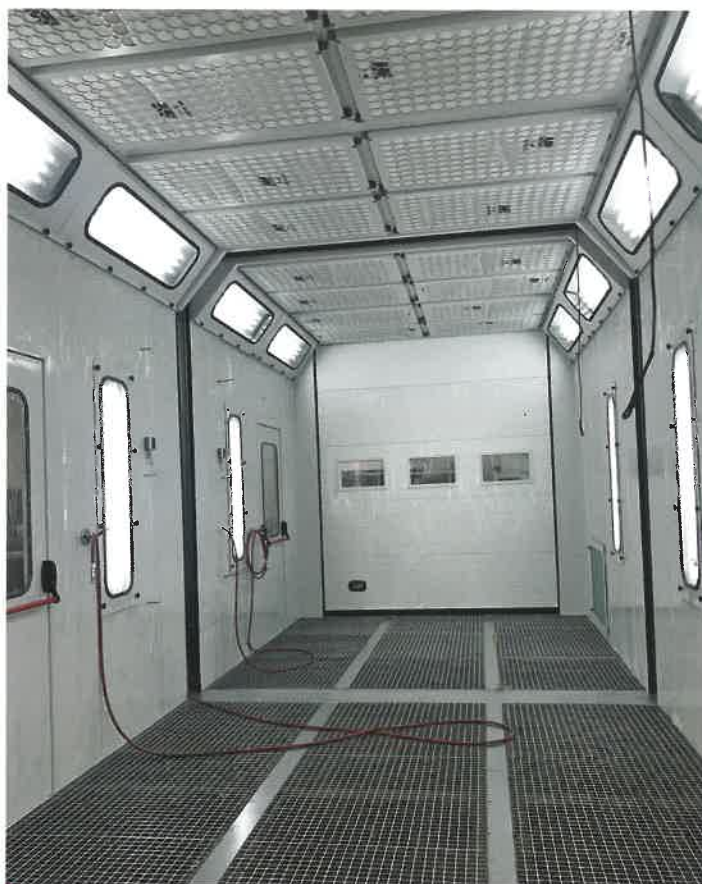
Vue de l'intérieur de la cabine
